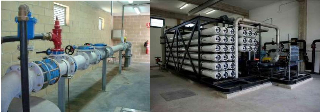
Pou Municipal de captació i ETAP tipus d'aigües del Prat, S.A.
